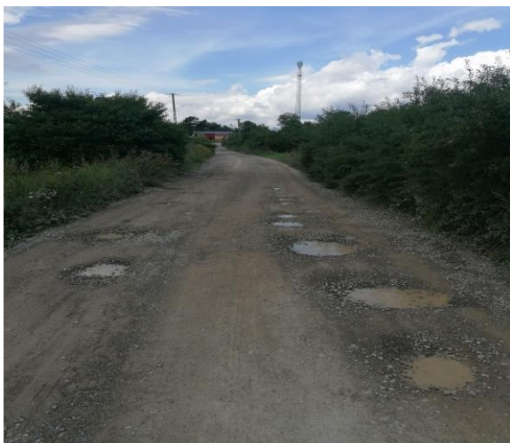
Droga przed naprawą
